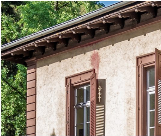
Abb. 3 | Verbindungshaus des Vereins Deutscher Studenten zu Heidelberg, Detail Fassade, Alfred Friedrich Buntschli, Heidelberg, Plöck 68, September 2022
